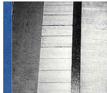
Abbildung 4 Schließlich ist auch festzustellen, dass die Edelholzsichten ungenügend verleimt sind und der Leim durch die Wärme spröde wird.
